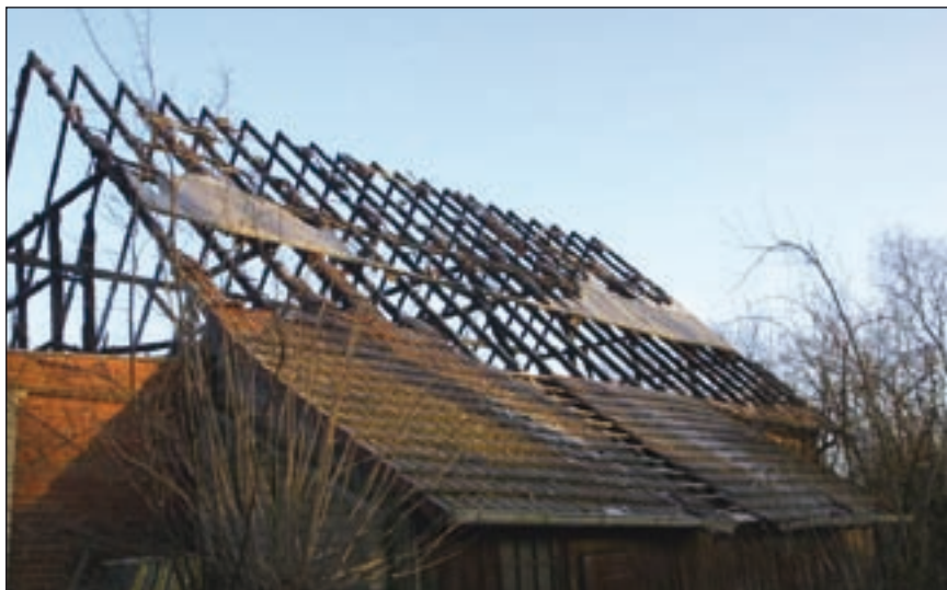
Bild 1: Feuer zerstört PV-Anlage
